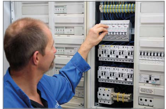
Bild 1: Verteilerschrank einer Elektroinstallation mit Schutzschaltern www.siemens.com
